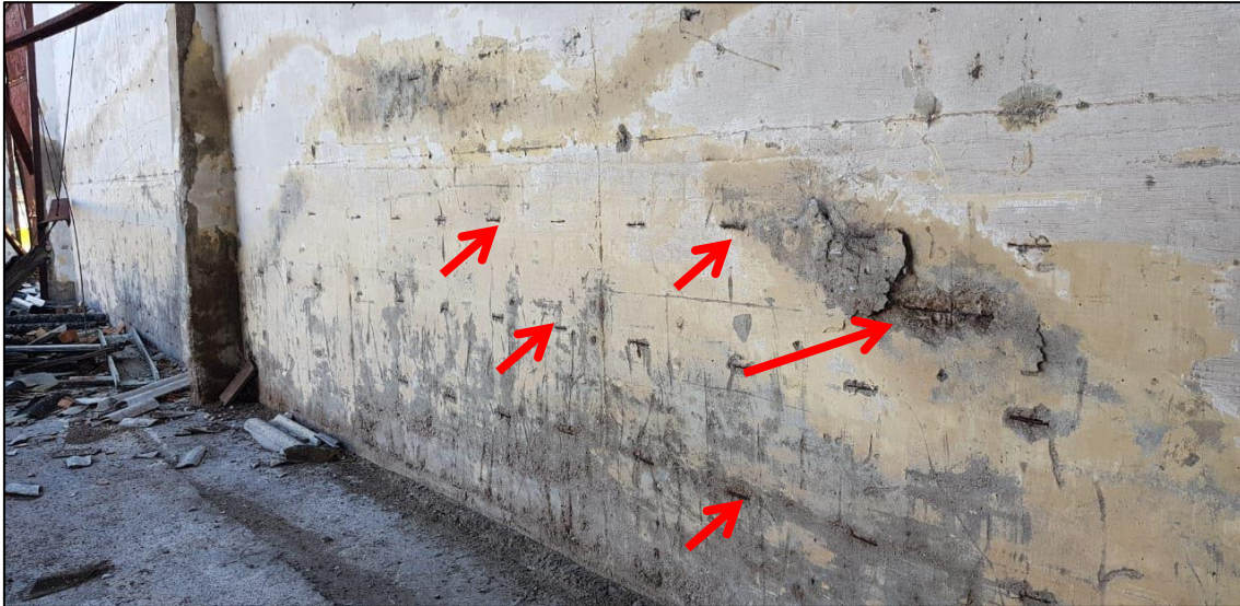
Figura 14 – Ferragem exposta e pontos com deslocamento de concreto
