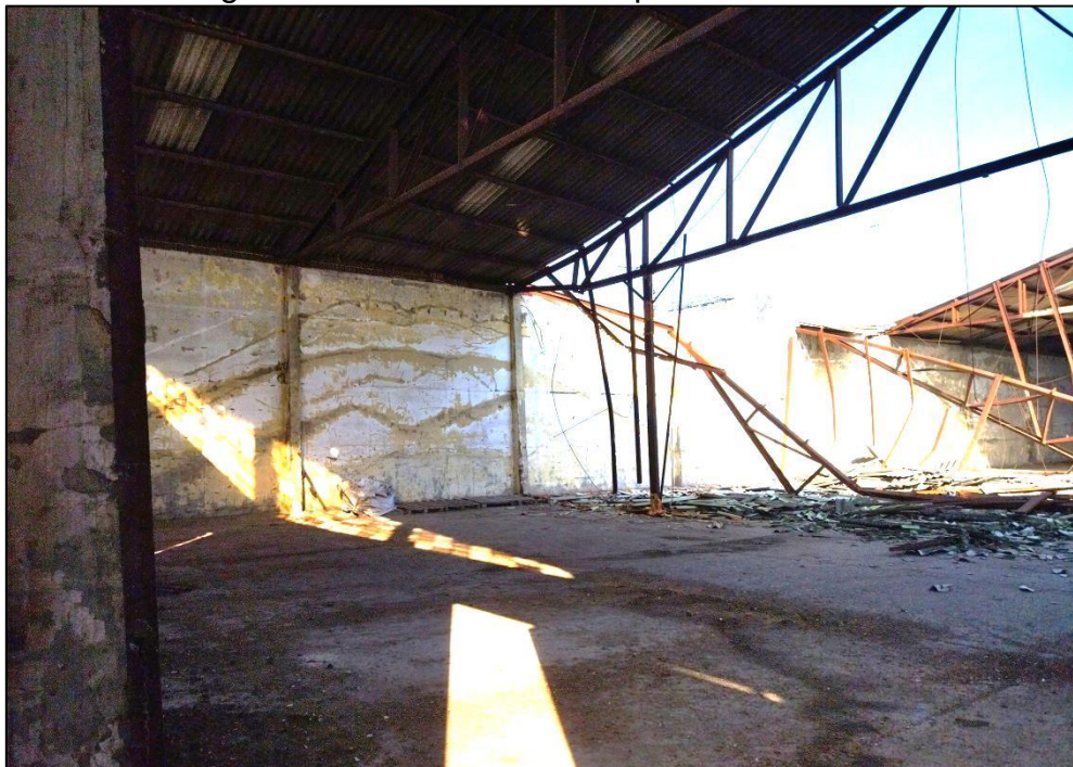
Figura 6 – Parte do telhado que não desabou.
