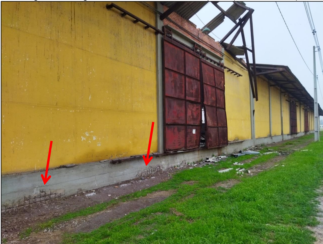
Figura 17 – Viga baldrame com armadura exposta (Fachada oeste)
