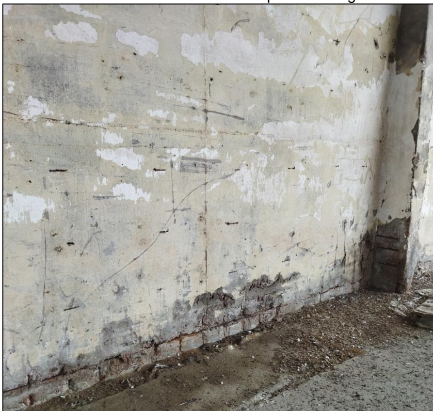
Figura 7 – Paredes internas com armadura exposta e desgastes na superfície.
