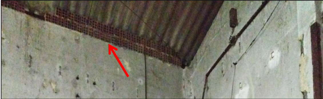
Figura 16 – Vedação parcial e inadequada entre as paredes e o telhado
