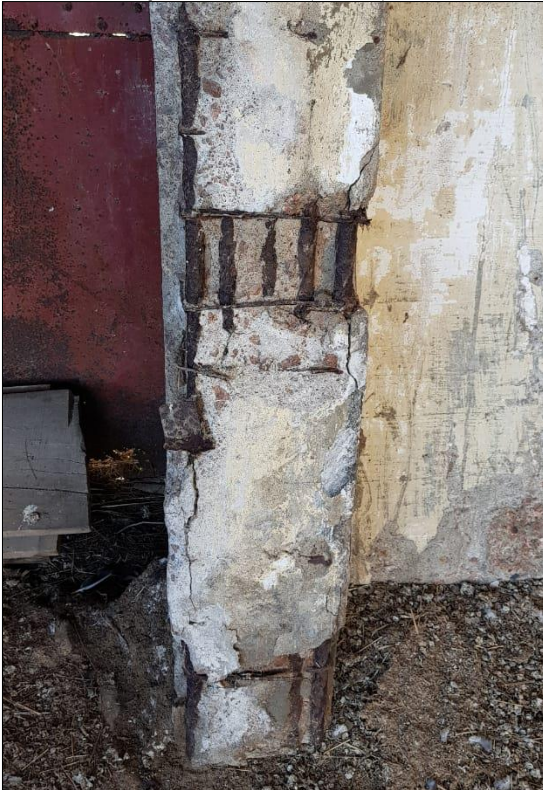
Figura 12 – Armadura exposta em pilar.
