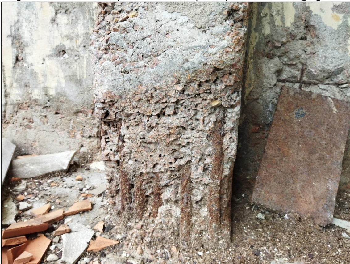
Figura 15 – Armadura exposta na base do pilar e porosidade dos agregados
