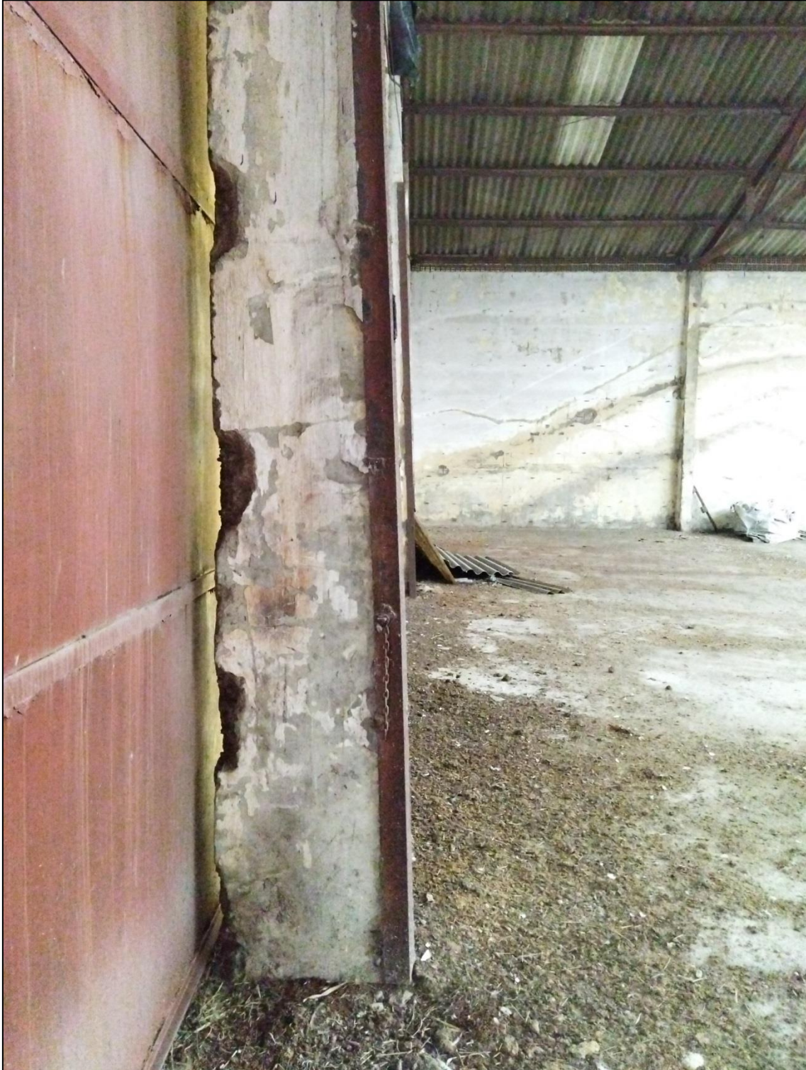
Figura 8 – Danos causados nos cantos dos pilares no (Portão fachada Norte).
