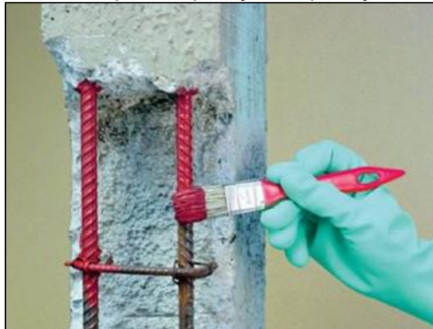
Figura 29 – Exemplo de aplicação de proteção a corrosão
