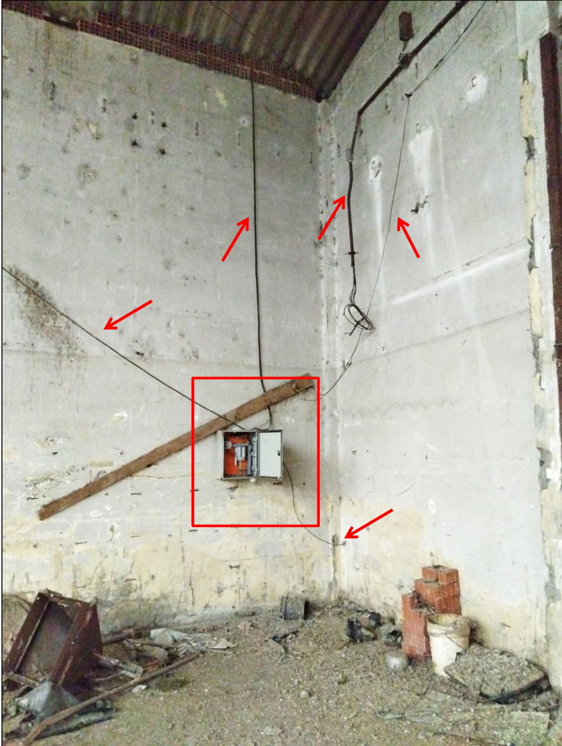
Figura 9 – Sistema Elétrico da edificação, inadequado (Fachada Oeste/Norte).
