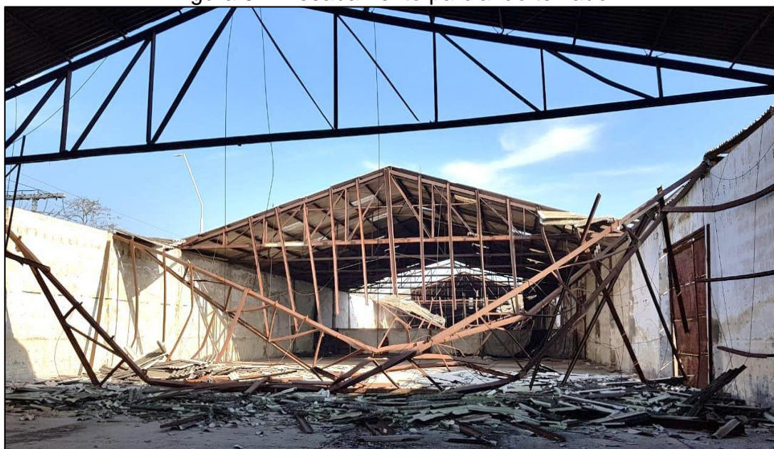
Figura 5 – Desabamento parcial do telhado.
