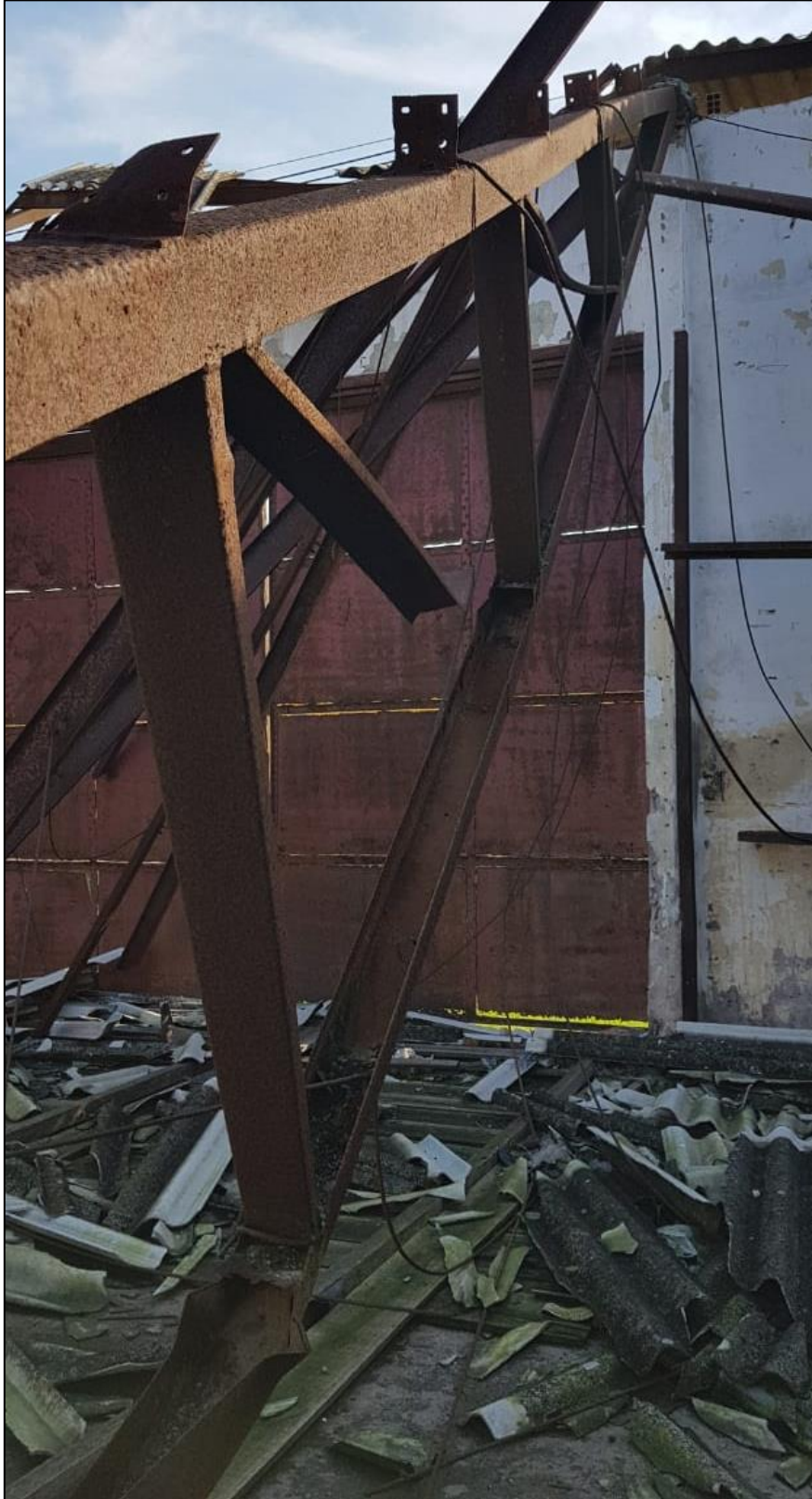
Figura 13 – Oxidação na treliça que colapsou.
